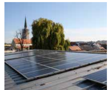
Die Photovoltaik-Anlage auf dem Dach der Kindertagesstätte St. Johannes ist fertig.
